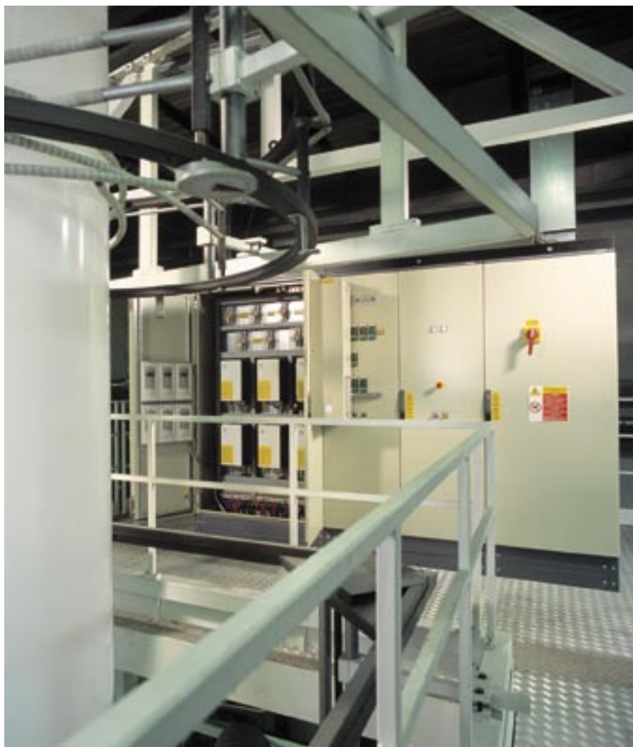
C'est l'armoire électrique qui abrite le plus souvent les variateurs. Ils sont reliés aux moteurs par des fils qui courent parfois dans toute l'usine. Mais pour répondre aux besoins de modularité des industriels, les constructeurs proposent désormais des solutions décentralisées. Les variateurs sortent des armoires pour venir prendre place au plus près du bloc moteur.
