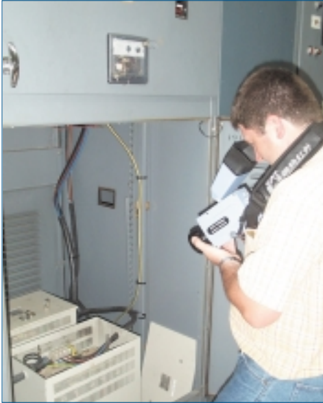
Les caméras matricielles sont couramment utilisées pour contrôler les armoires électriques et détecter les fils électriques chauds. Si l'on veut faire des mesures (donc rechercher une température, avec une incertitude associée) sur des fils de relativement faible diamètre, il est important de connaître ce qui se passe à l'intérieur de la caméra. Faute de quoi, la mesure risque de ne pas avoir une grande signification...
