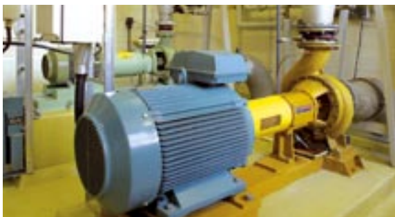
Les applications centrifuges, comme les pompes notamment, gagnent particulièrement à être équipées de vitesse variable.
